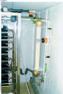
Ultrafiltration, départ de boucle. CH St nazaire.
