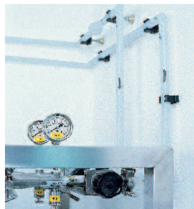
Départ et retour de boucle en PVDF avec raccordement tri-clamps sur l'osmoseur PERMODIAL - Certifiée CE med
